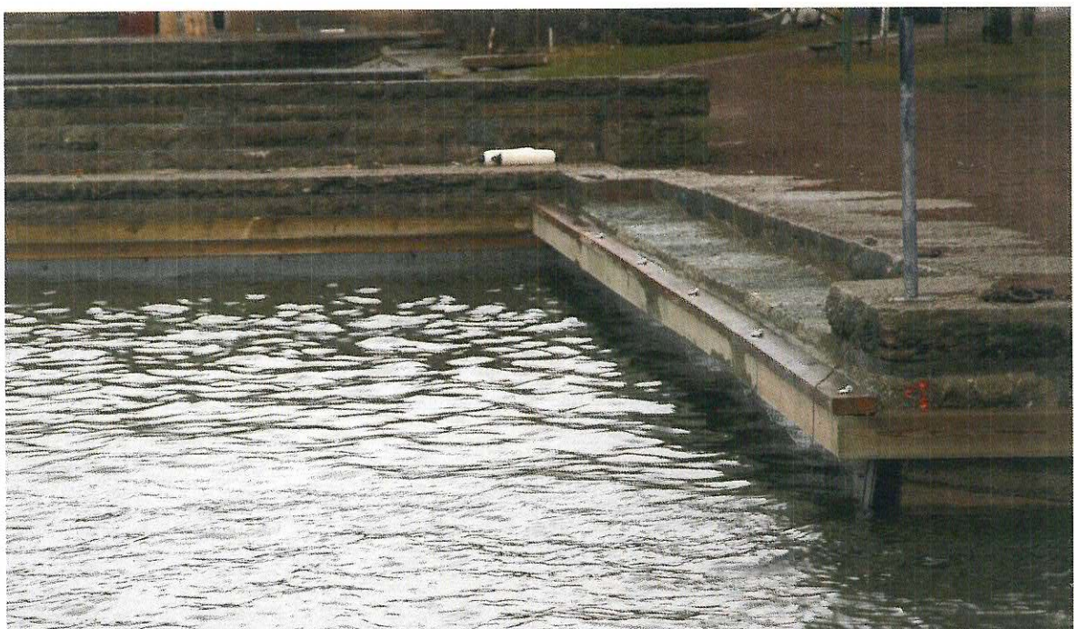
Kaj H efter att utförandet korrigerats.
