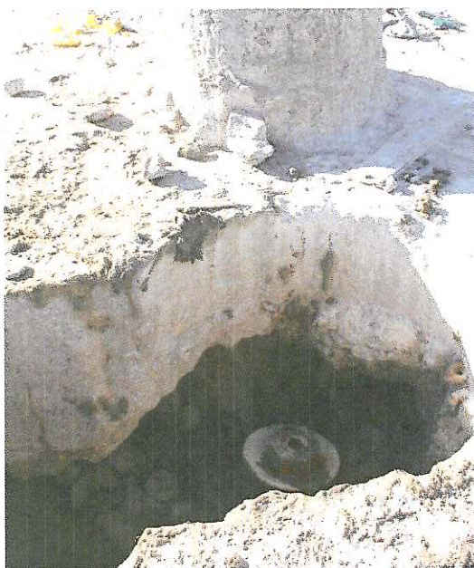
Stålpåle nedslagen till berg för att, senare när den försetts med "krage" och pågjutning, kunna ge stöd åt betongplattan från 1970-talet.
