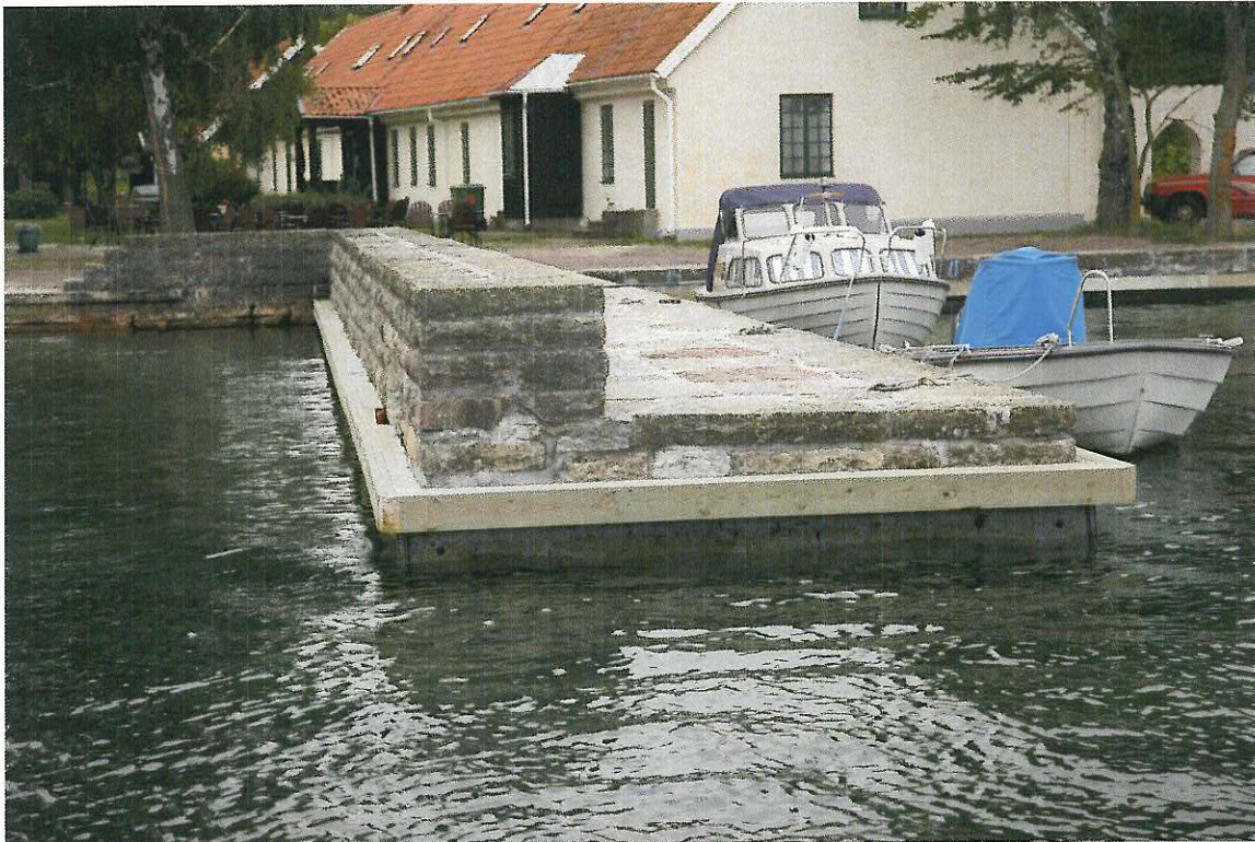
Pir C efter reparation. Under avbärarlisten kan plastsponten med sin fastsättning anas.
