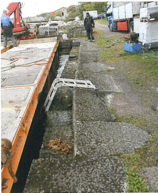
Kaj H. Kajkanten och marken innanför hade sjunkit. Delar av stenen hade mycket bristfälligt stöd med rasrisk. I beläggningen fanns en avsats/ trappa.
